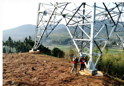
国网咸宁供电公司检修员开展除夕保电特巡
