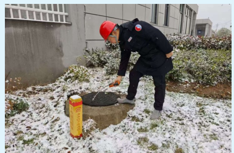
图为工作人员在进行天然气管道专项检查,全面筑牢安全防线
