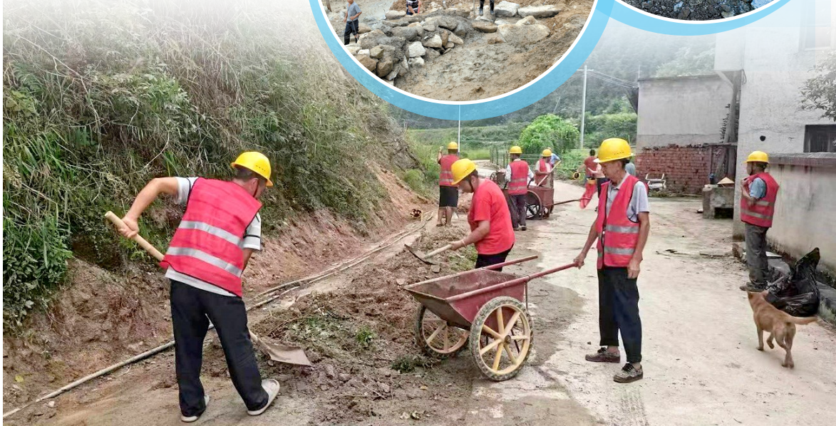
通城县马港镇丁山村道路提档升级2023年中央财政预算内以工代赈示范工程项目
