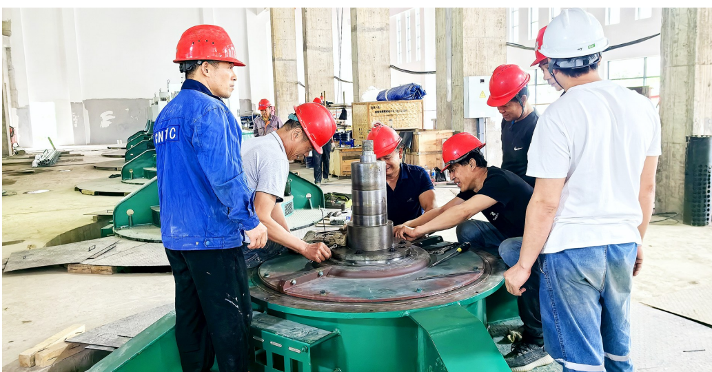
近日,嘉鱼县余码头泵站更新改造施工现场,工人正抓紧施工。 记者 谭宏宇 摄
