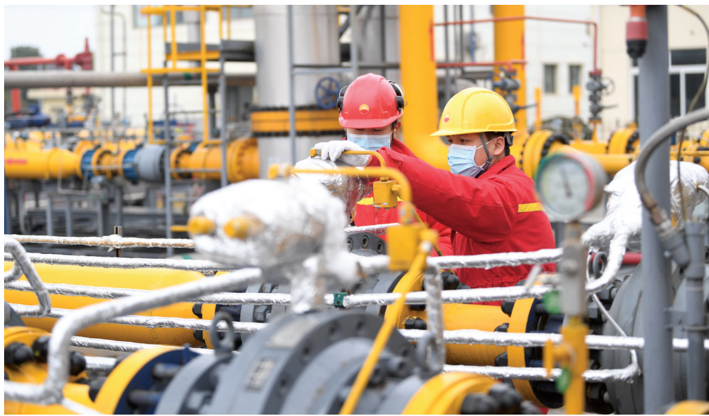
2月3日,正月初三,中石油昆仑燃气有限公司咸宁天然气门站值班人员在观测供气压力情况,确保城区10万余户居民用气稳定安全。
