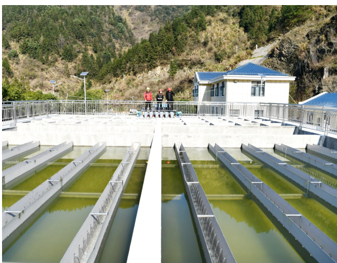
工作人员检测改扩建水厂试运行情况
