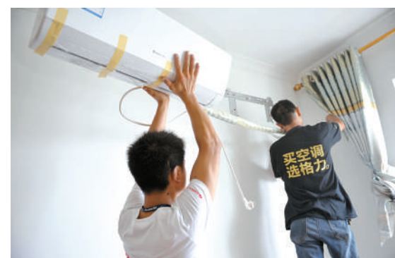
悬挂空调壁机
