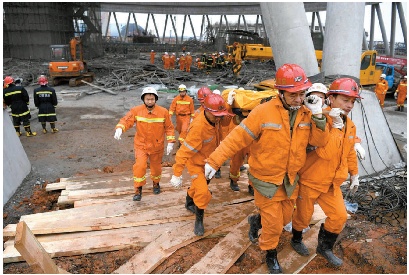
11月24日,救援人员将遇难者遗体抬出事故现场。记者从现场指挥部获悉,截至11月24日18时,江西省宜春市丰城电厂三期在建冷却塔施工平台坍塌事故死亡人数已上升至67人。目前,现场搜寻清理工作仍在进行。 据新华社
