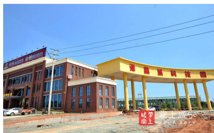
咸宁津晶城科技园,投资15亿元投资新建厂房、办公楼,总占地500亩,主要搭建企业孵化器和企业创业平台,于2016年下半年厂房、办公楼初具规模,园区全部建成投产后可创造30亿元产值,创税1亿元。目前已完成项目展示厅建设,部分厂房、办公楼即将竣工,剩余征地拆迁和土方平整正在加快推进,园区正在全国招商。
