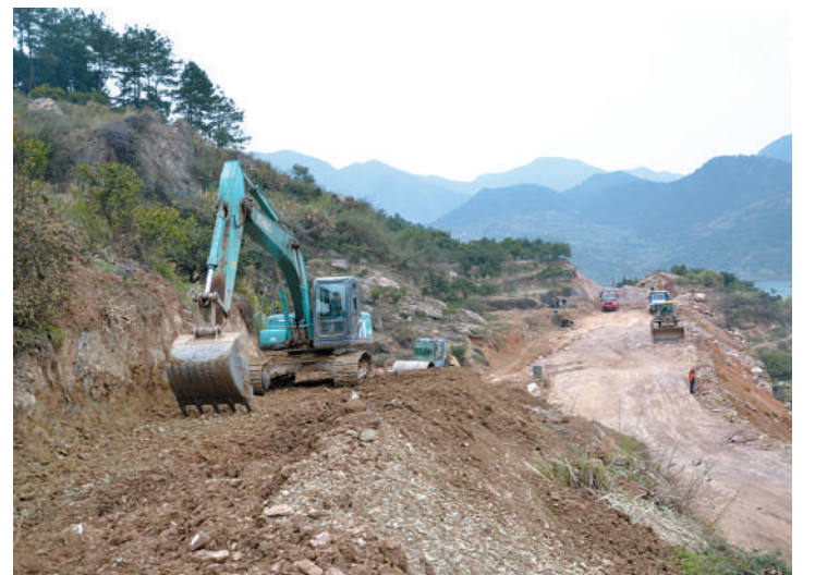
连日来,大慈线公路改建现场,挖掘机、压路机正在对一段翻山路段进行拓宽、压实。作为幕阜山生态旅游公路的一部分,全长11公里的大慈线改建工程目前已完成70%的路基工程。该工程的兴建,将极大地优化通山交通路网格局,隐水洞等景区的区位优势将进一步凸显,进而带动全县旅游经济的发展。 通讯员 阮晓东 邓振 摄
