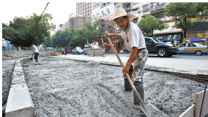
7月27日,温泉路中百仓储公交站,工人们正在建设港湾式站台。
