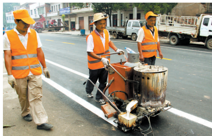
12日,嘉鱼县陆溪镇吴王路,工人们正在施划交通标志线。为打造省级卫生城镇,该镇对吴王路、玉带河路、二忠路等8000多米路段进行改造升级,在学校、医院出口及三叉路口等地设置斑马线、禁停牌及停车标线,营造规范有序的道路交通环境。 记者 夏正锋 通讯员 周晓林 摄
