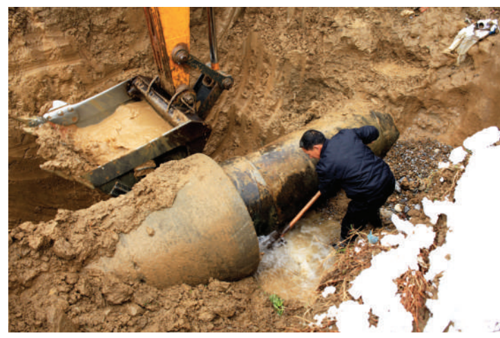
8日晚，通山县自来水公司组织人员冒雪抢修破裂管道，保障了城区3万余户居民的用水。
