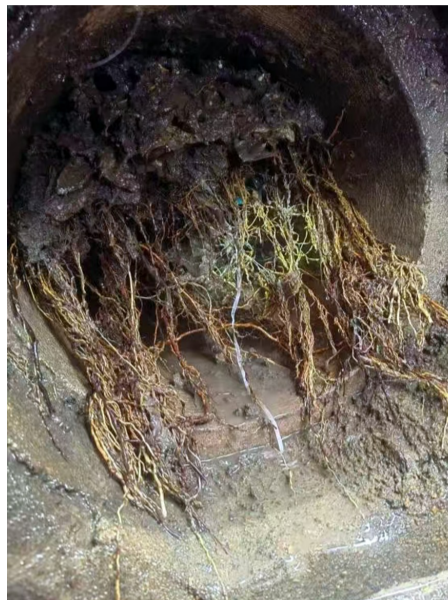
▲原有雨水支管淤积堵塞严重
