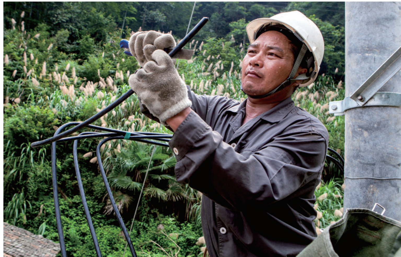
7月15日,崇阳县供电公司员工顶着38℃高温为肖岭乡金不村4组增容配电变压器。邓东峰/摄
