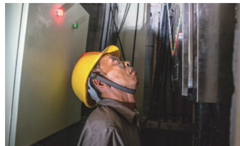
柳宏国在检查崇尚华府小区的电缆井。邓东峰/摄
