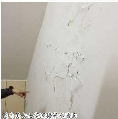
图为吴女士家阁楼渗水墙面
