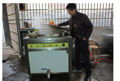
南门小学电气化厨房中的多功能液态导热锅。
