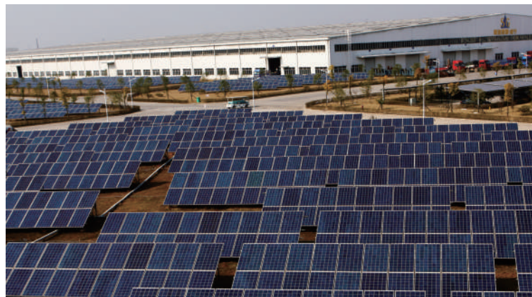
南玻集团光伏发电电机组。
