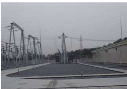
220kV通城变布局协调,简洁美观
