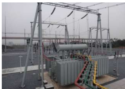
主变安装规范,运行可靠
