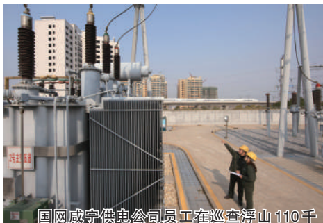
国网咸宁供电公司员工在巡查浮山110千伏变电站,确保城铁咸宁南站的安全可靠供电。
