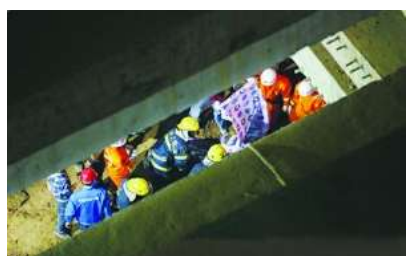
施工人员分析认为:“引发这次事故的原因,很有可能和西安近期降雨导致泥土疏松有关,具体事故原因还有待进一步确认。”
